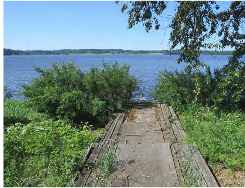
Pihaterassilta johtaa puurakenteinen erittäin huonokuntoinen terassikäytävä rantaan laiturille.
