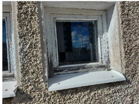
Kuva 2. Puuosien hilseilyä ikkunan alaosissa.
