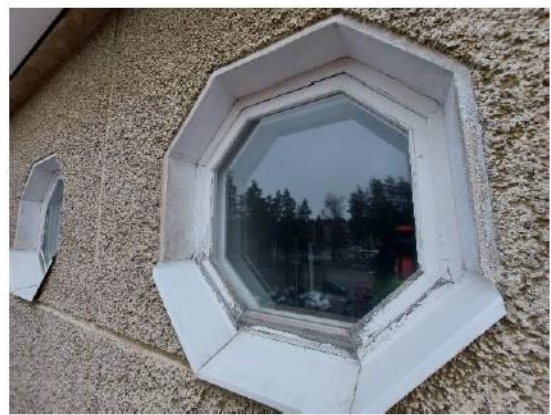
Kuva 4. Maalipinnan vaurioita ikkunan alaosissa.
