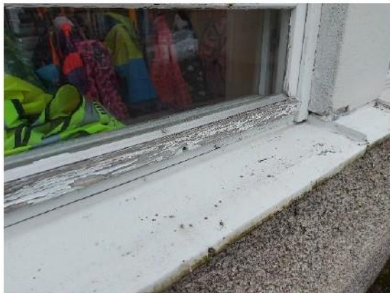
Kuva 1. Ulkopuitteen maalipinnan hilseilyä.
