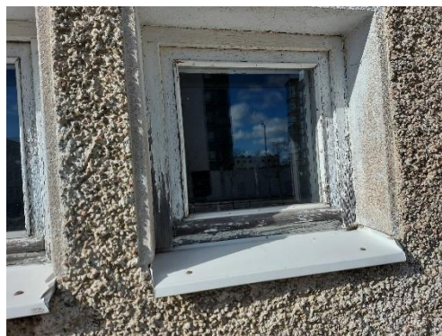
Kuva 2. Puuosien hilseilyä ikkunan alaosissa.
