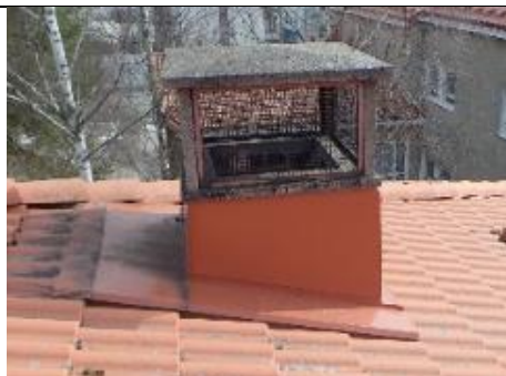
Kuva 44. Vesi pääsee lammikoitumaan hormin pellityksen tiivistematolle.
