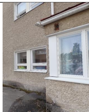
Kuva 50. Vanhalta vesikatto-osuudelta puuttuu syöksytorvi (esiopetuksen keittiötila).
