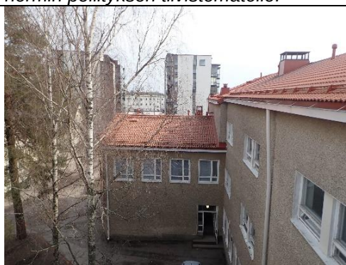
Kuva 46. Ulokeosan vesikourun puutteellinen kaato.
