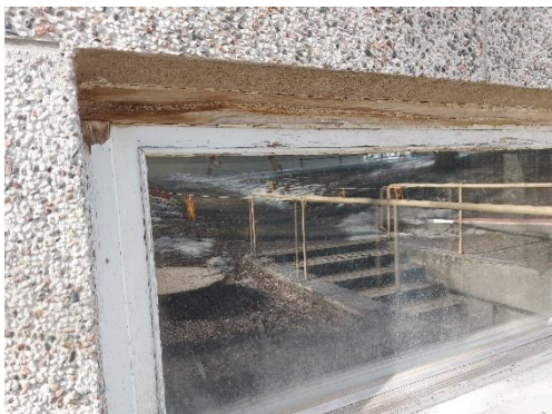
Kuva 9. Kosteuden vaurioittamaa puuta (lahoa) kellarin ikkunan yläreunassa.
