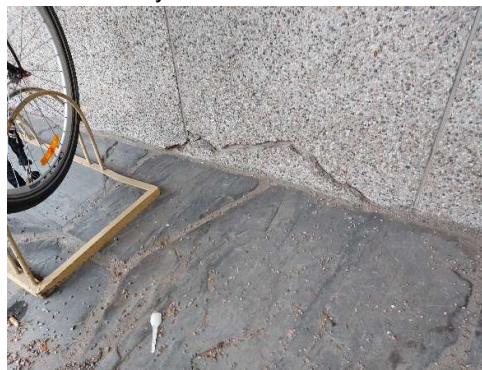
Kuva 14. Sokkelin alaosaan laatta murtunut ilmeisesti mekaanisesta iskusta.
