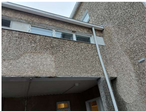
Kuva 7. Vauriota katon ja seinän liittymän alapuolella sekä seinän alaosassa.
