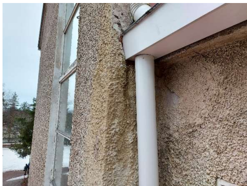
Kuva 11. Rappauspinnassa aiemmin laastipaikkauksin korjailtu kohta ilmeisesti vuotaneen rännin kohdalla.
