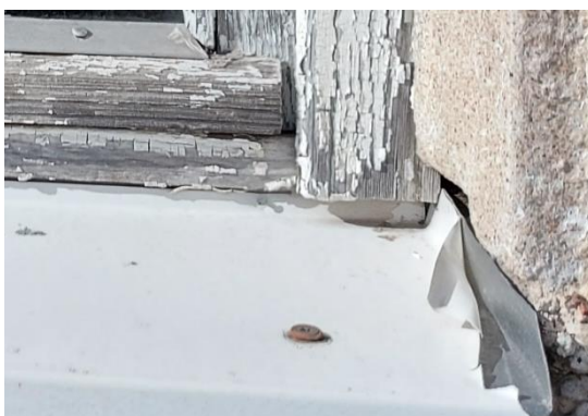
Kuva 16. Pellityksen tiiveydessä on paikoin puutteita.
