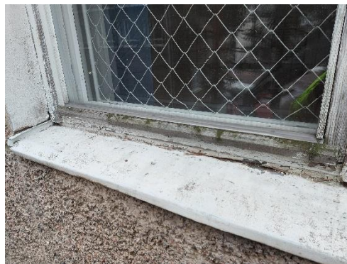
Kuva 10. Ulkopuitteen alaosaassa sammalkasvustoa.
