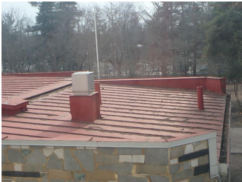
Kuvat 53 ja 54. Todennäköisesti viimeisen ilmanvaihtokoneremontin yhteydessä on uusittu piharakennuksen peltikate ja lisälämmöneristetty yläpohjarakennetta. Vanhana lämmöneristekerroksena on lastuvillalevy. Vesikattorakenteessa ei havaittu aluskattea. Katteessa on näkyvissä hieman maalipinnan hilseilyä.
