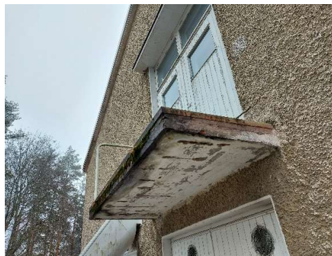
Kuva 20. Parvekkeen alapinnan teräkset ovat voimakkaasti ruosteessa ja terästen ympäriltä on lohkeillut betonia.
