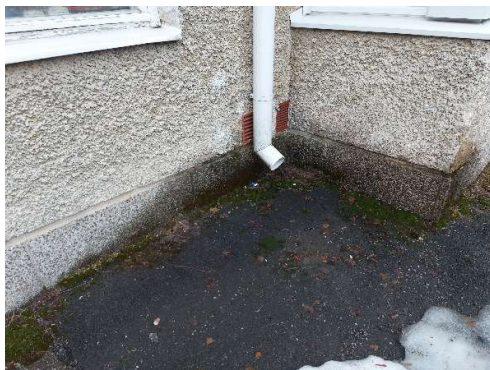
Kuva 13. Pystyrännistä asvaltille valuva vesi roiskuu ja kastelee ympäröivää sokkeliä ja seinän alaosa.
