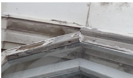
Kuva 15. Ikkunalasin ja puitteen välissä havaittiin rako.
