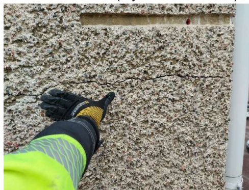
Kuva 10. Vaaakasuuntaista halkeamaa betonipalkin kohdalla olevassa rappauksessa.
