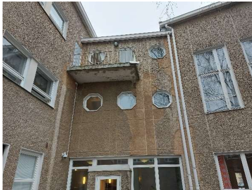
Kuva 5. Julkisivurappauksessa parvekkeelta valuneen veden aiheuttamia vaurioita.
