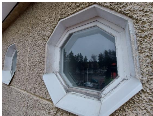
Kuva 4. Maalipinnan vaurioita ikkunan alaosissa.
