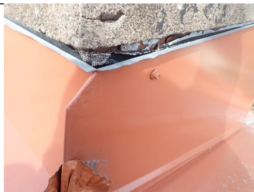
Kuva 40. Hormin pellityksen liittymä on avoin.
