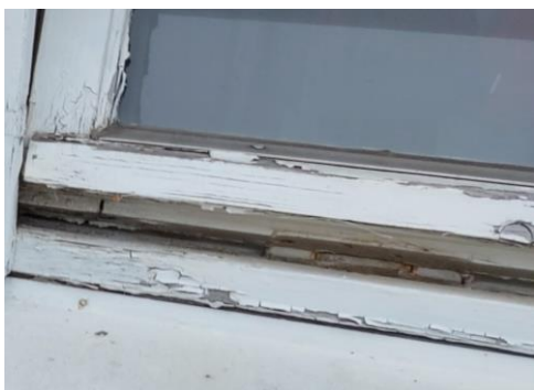
Kuva 11. Ruostunut sarana koillisjulkisivun yläosassa.
