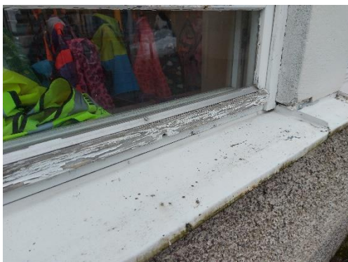
Kuva 1. Ulkopuitteen maalipinnan hilseilyä.
