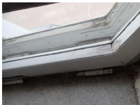
Kuva 12. Ulkopuitteen saranan kulunut maalipinta.
