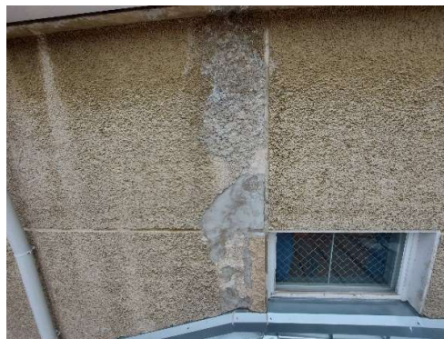
Kuva 8. Vanha vesikattovuodon aiheuttama vaurio (räystäällä halkeama).
