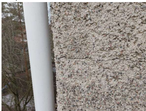
Kuva 9. Vaaakasuuntainen halkeama rappauspinnassa ulkoseinän kulmassa. Kohdalla rappauksen alla betonipalkki.
