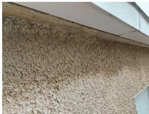
Kuva 12. Seinän yläosassa rappauksen pinnassa oleva maali on hyvässä kunnossa, josta johtuvat seinäpinnassa havaitut sävyerot.
