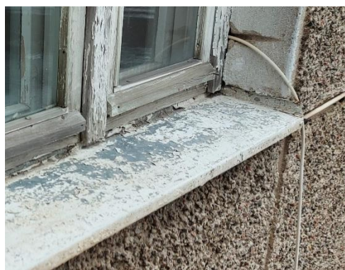
Kuva 17. Ikkunapellitysten kaadot eivät ole kaikilta osin riittävät.
