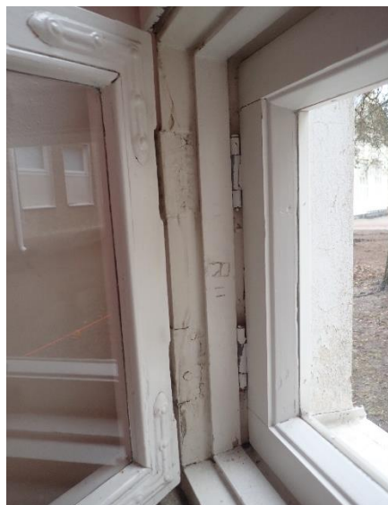
Kuva 6. Sisäpuutteen ja välikarmin maalipinnat ovat vielä kohtalaisessa kunnossa.
