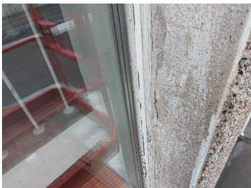
Kuva 13. Ikkunakarmin ja ulkoseinän liittymän tiivistys halkeilee.
