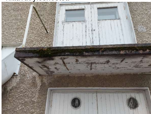
Kuva 19. Päädyn parvekkeen pintalaatan ja peruslaatan välissä kasvaa sammalta.
