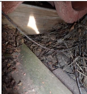
Kuva 42. Aluskatteen päälle on kertynyt roskaa rikkinäisen laatan kohdalla.
