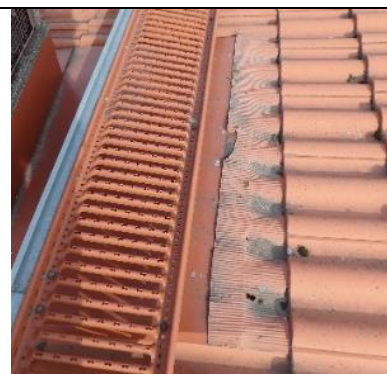
Kuva 45. Reikä hormin pellityksen ja kattotiilien välisessä tiivistematossa.
