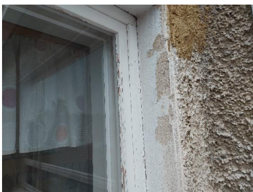
Kuva 7. Puuosien maalipinnan lievää irtoamista.
