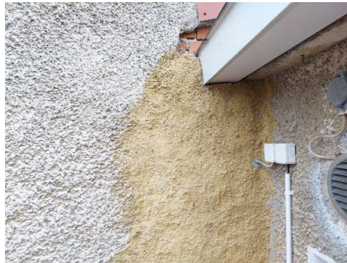
Kuva 6. Vuotaneen rännin aiheuttamia vaurioita rappauspinnassa. Korjaus on puutteellinen ja rännin yläpuolella on paljasta tiilipintaa.
