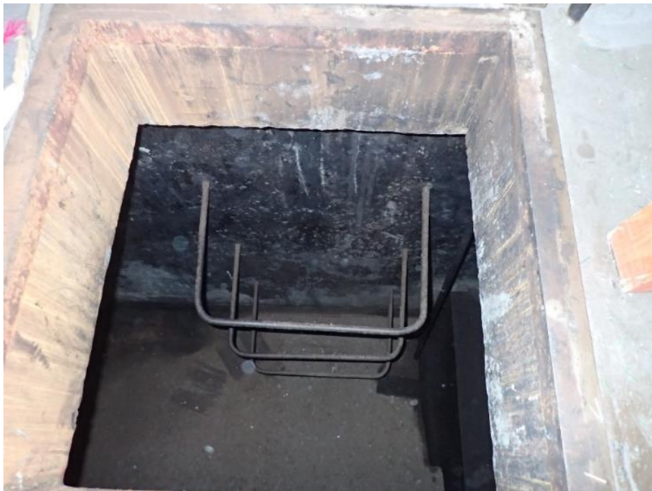
Kuva 8. Kellarikerroksen näyttämövaraston alapuolella on ollut käytössä betonirakenteinen öljysäiliö. Säiliön luukku ei ole ilmatiivis varastoon päin ja säiliössä on edelleen voimakasta öljymäistä hajua. Öljysäiliön ja varaston välipohjarakenteena on 250 mm betonia. Voimakkaan hajun takia säiliön rakenteita ei tutkittu tarkemmin.
