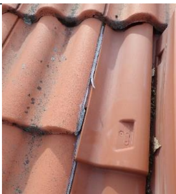
Kuva 39. Läpivientikappaleiden tiivistykset rakoilevat.
