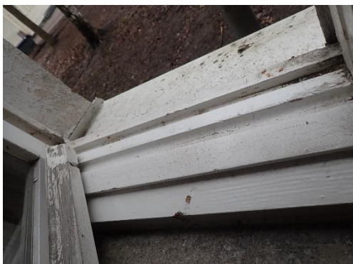
Kuva 5. Välakarmissa on jonkin verran kolhuja, mutta maalipinta on vielä kohtalaisessa kunnossa.
