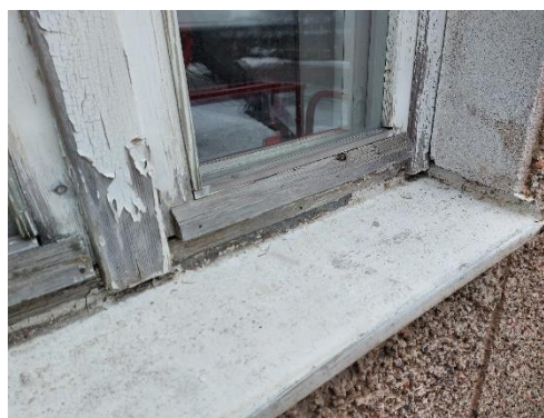
Kuva 8. Ikkunoiden puuosissa ei havaittu laajaa lahoa, vaikka maalipinta on paikoin täysin irronnut.
